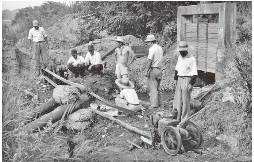
苦勞した水不足 (笹部・奈良井川右岸・昭和30年代)
