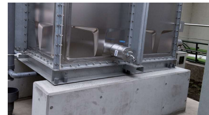
受水槽に設けた給水栓
