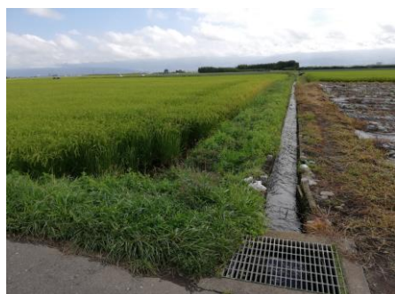
(改修が必要な水路)
