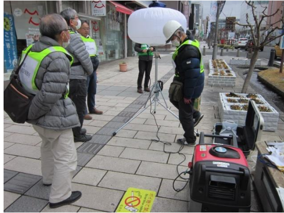
【発電機、投光器の動作確認】
