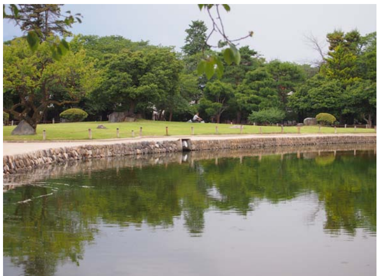
写真 5-7 内堀に埋め込まれて設置されているライトアップ用の照明機器
