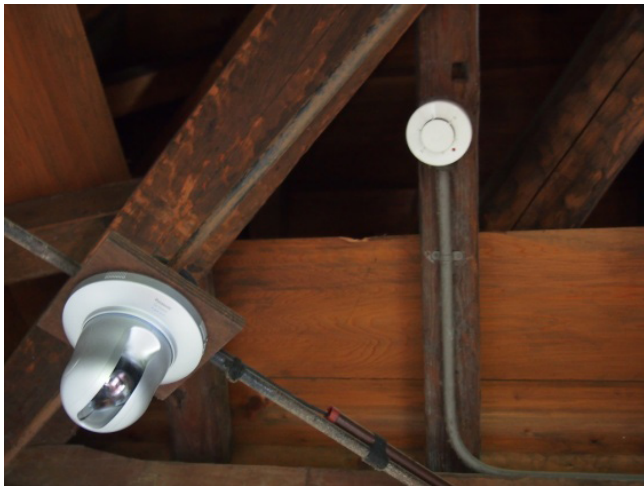
写真 4-3 防災監視カメラ
