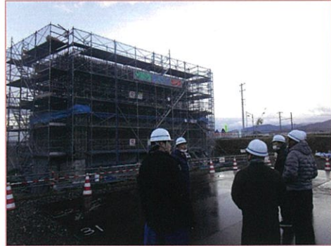
松本波田道路 (仮称)新村高架橋 国道158号と上高地線を跨ぐ橋梁の下部工事
