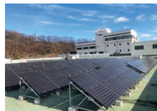
屋上に設置された太陽光パネル
