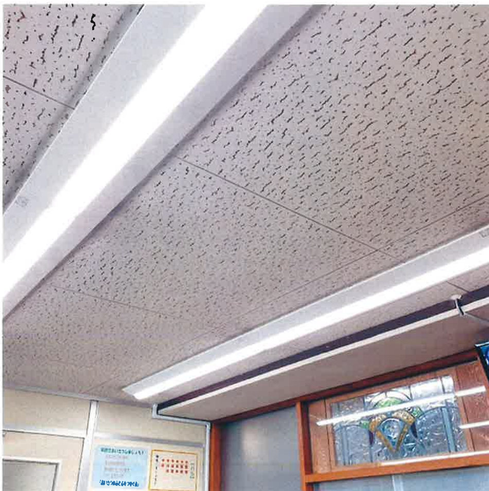
本社全フロアの LED 照明
