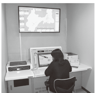
防災無線の操作室
