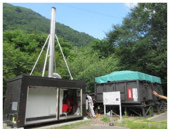
波田 竜島温泉チップボイラー
