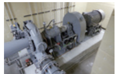
寿配水地省力発電所の発電機
