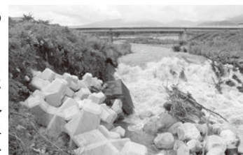
▲野尻橋下流した。
