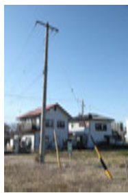
② 電柱と支線
