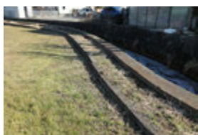
㉕ 畦畔ブロック
