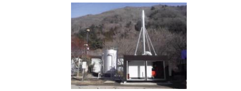
(木質チップボイラー)
