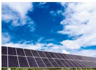
太陽光で発電を行うソーラーパネル
