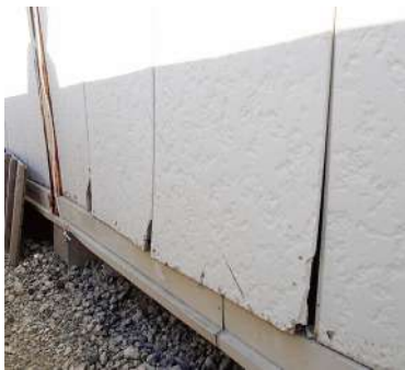
外壁がめくり上がり、老朽化した学童施設
