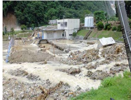
平成 30 年 7 月豪雨による水道施設の被害状況 (呉市工業用水道)
