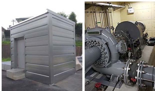
寿配水地 小水力発電設備
