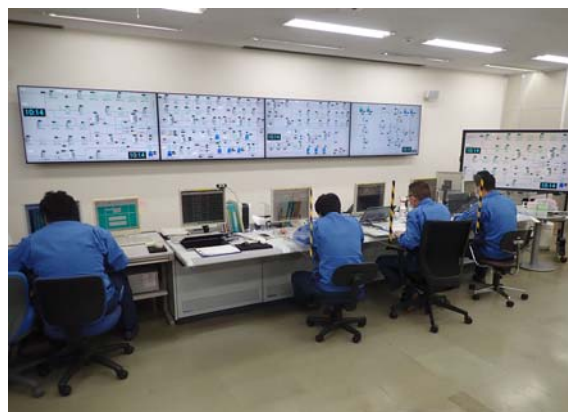
中央監視室の様子
