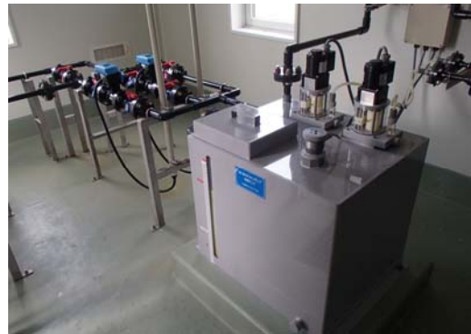
塩素注入設備（島内第2水源）
