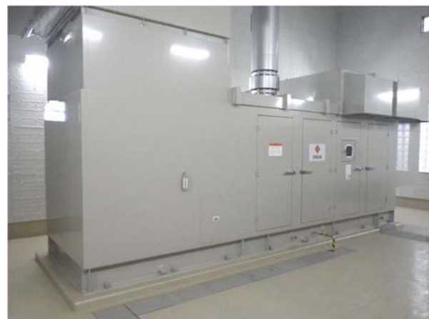
自家発電設備（島内第 1 水源）
