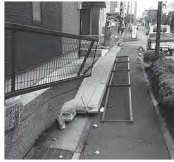
熊本地震で倒壊したブロック塀
