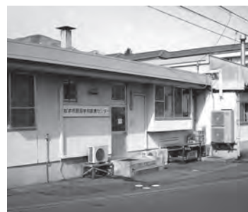
老朽化が著しく、建て替えが必要となっている波田学校給食センター
