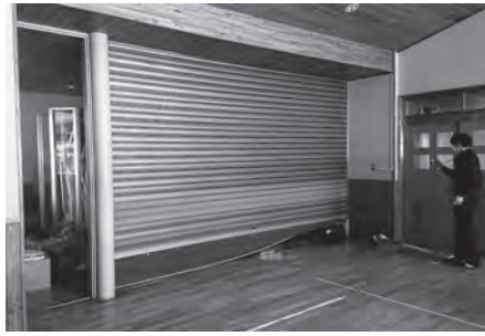
挟まれ防止等の安全対策としてシャッターの下部に耐火クロス(布)を設置
