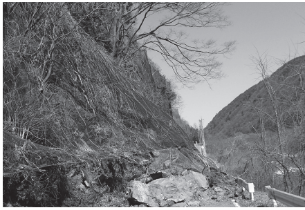
崩落により全面通行止めとなった県道大野田梓橋停車場線
