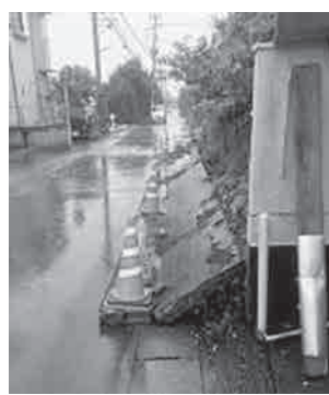
平成28年熊本地震で倒壊したブロック塀
