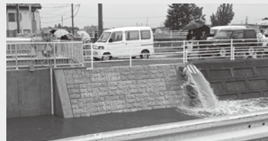
改修工事を終え、当日稼働した和泉川ポンプ施設
