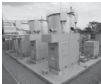
消化ガス発電設備
