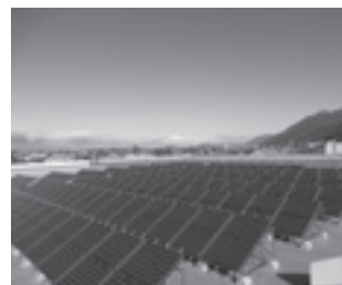
太陽光発電設備
