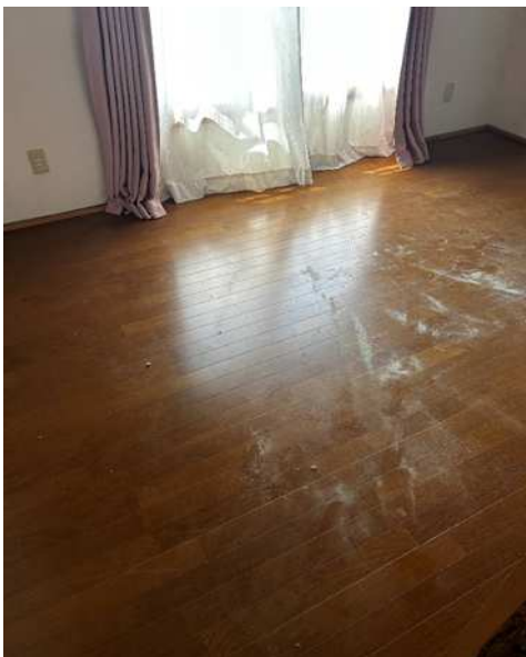
2階個室5 床板浮きあり 危険
