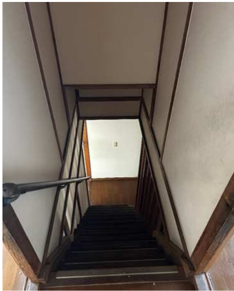
西階段2階 床板損傷あり
