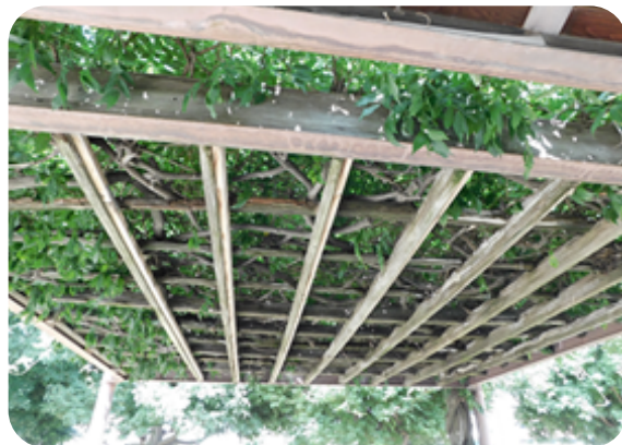
老朽化が進んだ南部公園の藤棚（修繕前の状態）
