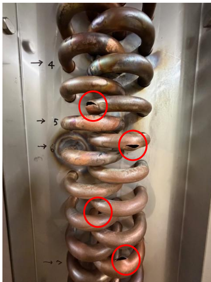
[破損状況：拡大①]
