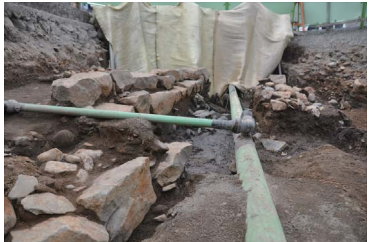
写真3 高さ・軸が違うことがわかる(4段目は緑色のガス管下から見つかりました。)
