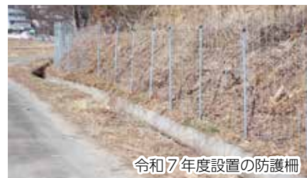
松枯れにより倒木した木が 防護柵を破損
