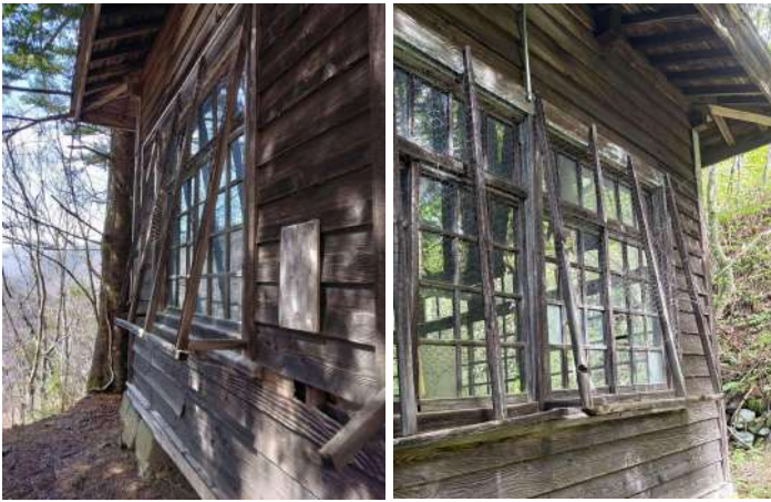
西外壁面防球ネット(フレーム+亀甲金網張り)
