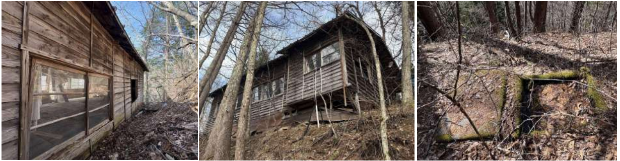
山側は基礎が埋もれている
