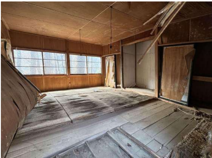
奥の12畳間。左手の間仕切りの建具は崩壊している。
