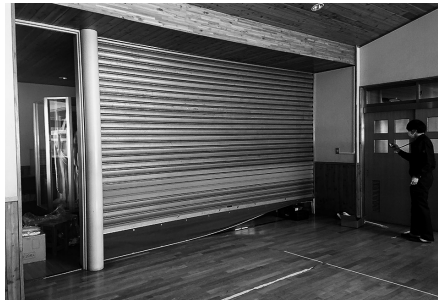
扶まれ防止等の安全対策としてシャッターの下 部に耐火クロス(布)を設置
