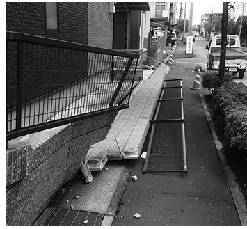
熊本地震で倒壊したブロック塀
