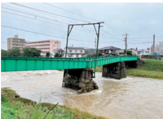
大雨により橋脚が傾いた上高地線
