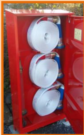
整備した消火栓ホース
