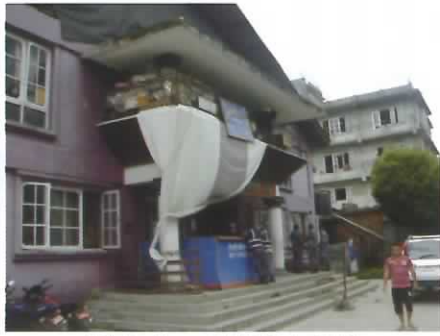
外壁と天井の一部が破損した武道館
