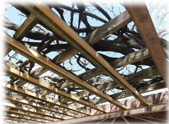
老朽化が進んだ南部公園の藤棚（修繕前の状態）
