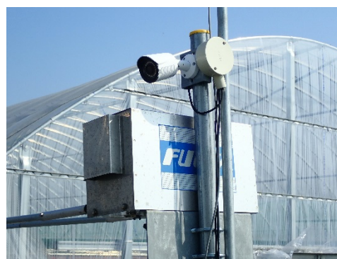
防犯カメラの設置
