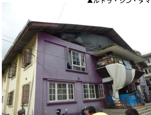
▲外壁と天井の一部が破損した武道館
