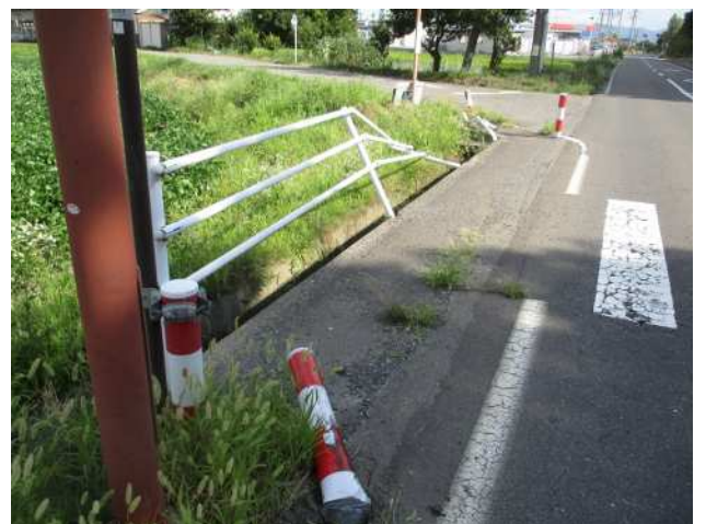
ガードパイプ等の破損
